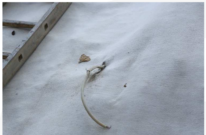
BVR 9000: Kabeldurchführungen / Öffnungen frei positionierbar
