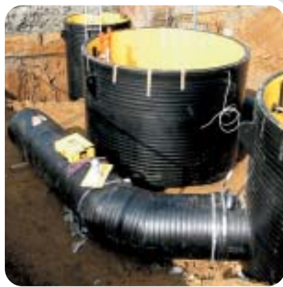
PKS-Entlastungs- und Drosselschacht
