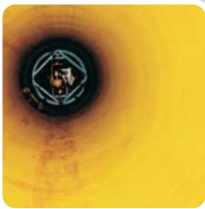
PKS-Kanalrohr mit heller Innenoberfläche
