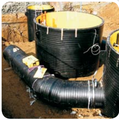
PKS-Entlastungs- und Drosselschacht
