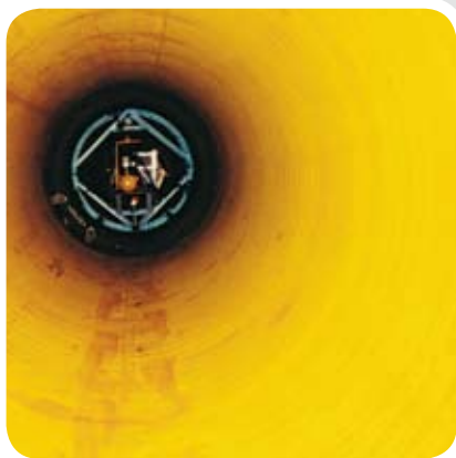
PKS-Kanalrohr mit heller Innenoberfläche
