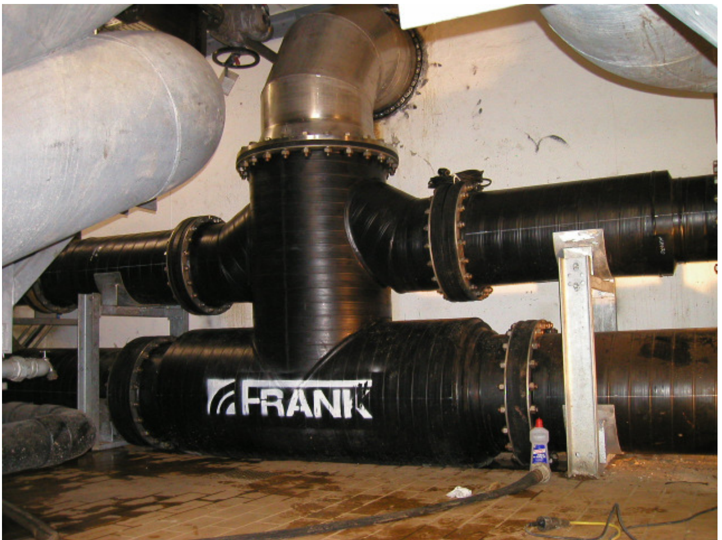
Das Herzstück der Schlammverteilung in die 4 Straßen der Dentrifikation - das „Hirschgeweih“ Hauptnennweite DN 800 mit Abgängen DN 500 und DN 600
