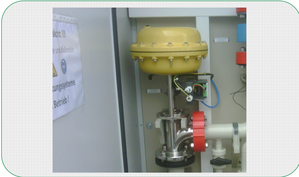
Abb. 1 Kalkmilchregelventil Typ 680 DN 65 im Schaltschrank
