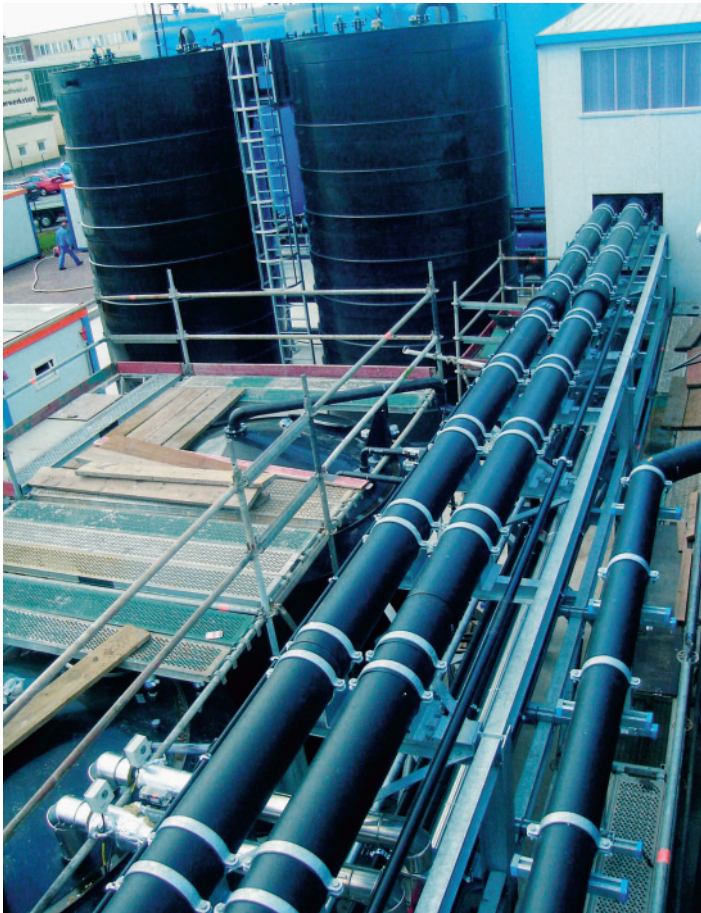
Bild 3: Frei verlegte PE-el Leitung für lösemittelhaltige Abwässer
