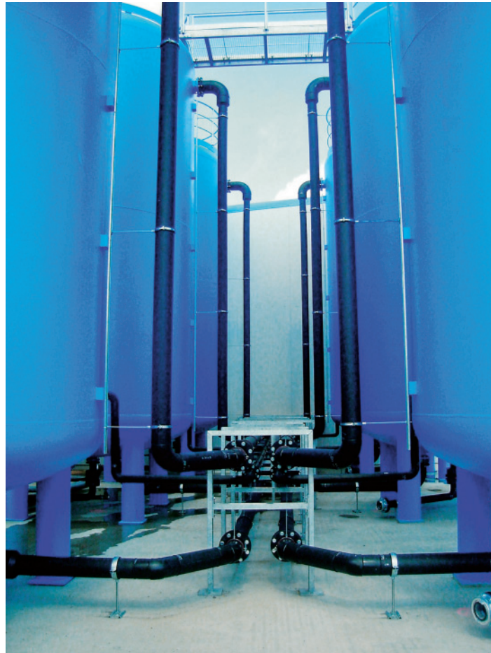
Bild 1: An Behältern installierte elektrisch leitfähige Kunststoffrohrleitung
