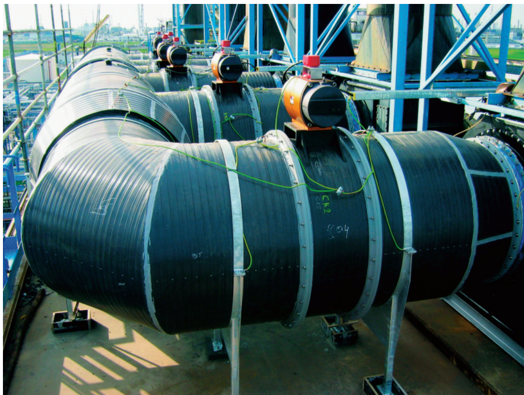
Bild 5: PPs-el Abluftleitung aus Wickelrohren und segmentierten Formteilen
