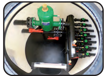
Verteilerschacht mit Mikroblasenabscheider
