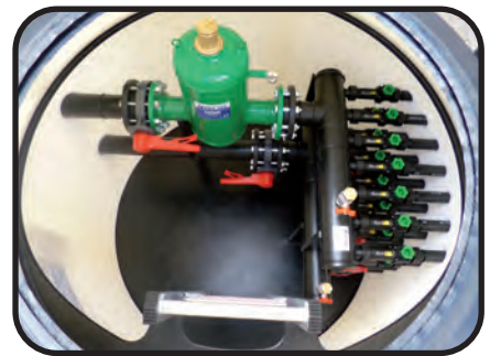
Verteilerschacht mit Mikroblasenabscheider
