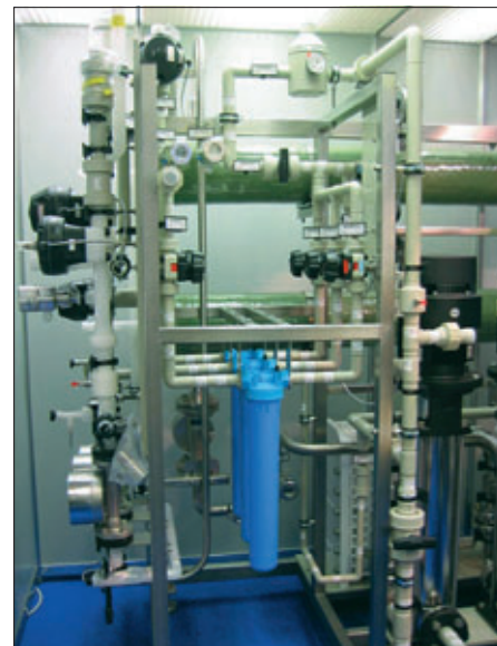
Bild 1: IR-geschweißte Rohrleitungen aus PP-R Fig. 1: IR-welded PP-R pipes
