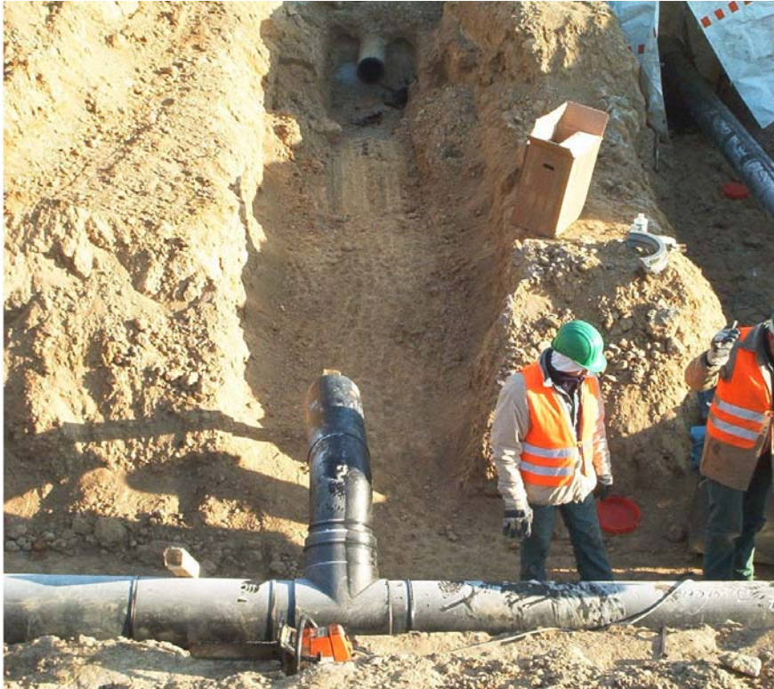
Bild 7: Abzweig von der Hauptleitung (DN 300) zur Sprinklerunterzentrale (DN 250)
