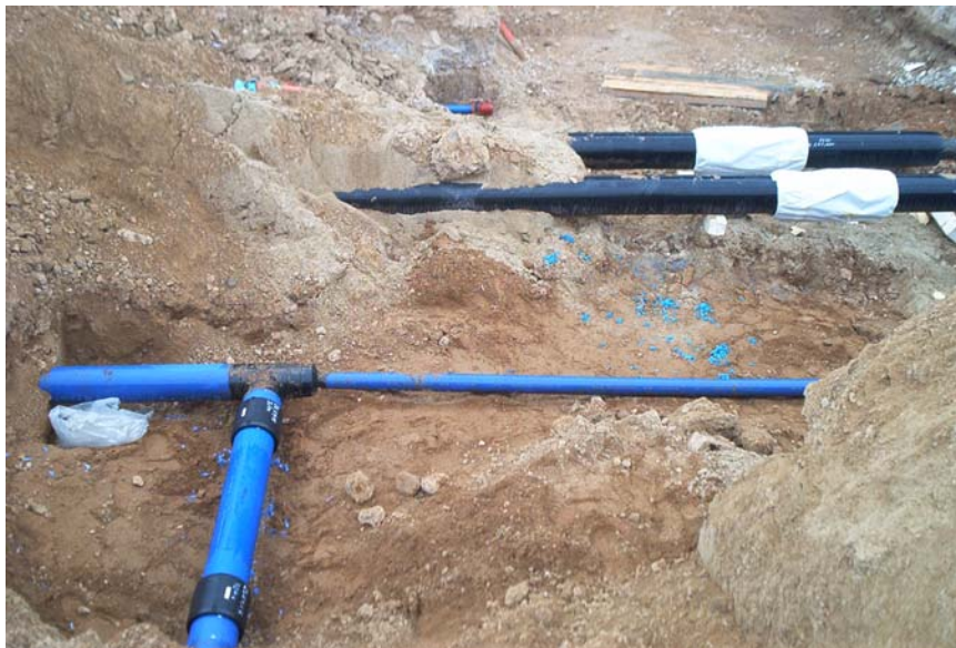
Bild 2: Agruair-Druckluftleitung und Löschwasserleitung (Hintergrund)
