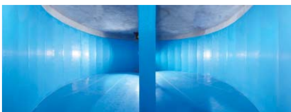
Bild 8. Mit PE-System ausgekleideter Rundbehälter.
