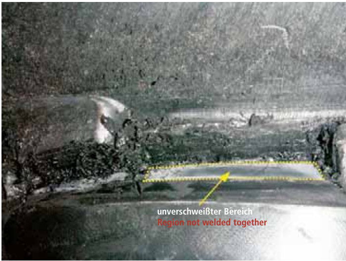
Bild 15: Schadhafte Kehlnaht- verbindung, unverschweißter Bereich
