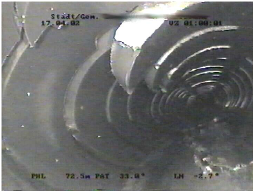
Abbildung 3: Risse im Sickerwasserrohr geschlitzt [5]
