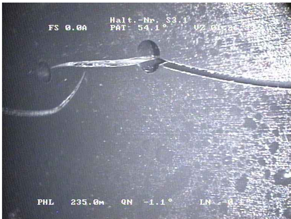
Abbildung 2: Längsriss im Sickerwasserrohr gelocht [5]
