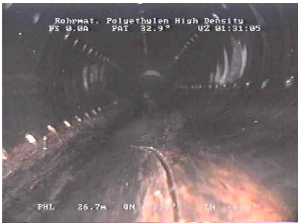
Abbildung 4: Risse im Sickerwasserrohr in der ungelochten Sohle [5]
