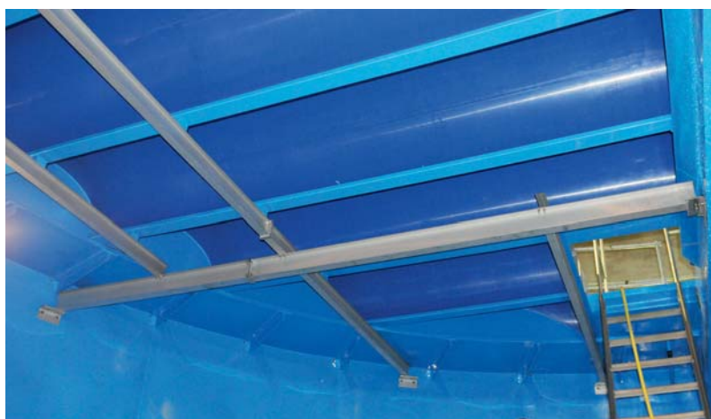
Behälterabdeckung mit Stahltraverse.
