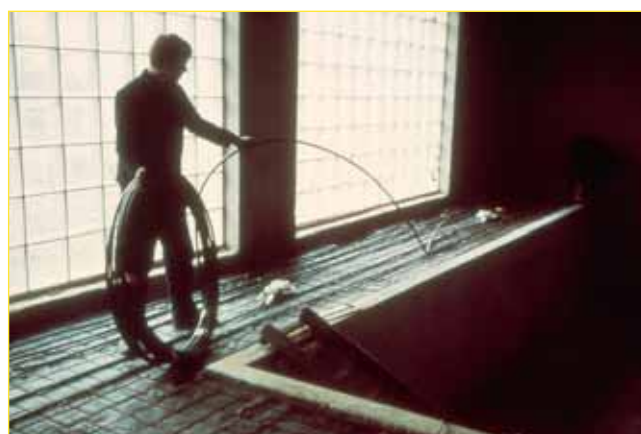
Bild 2: PEHD-Fußbodenheizleitungsrohre Ende der 60er Jahre
