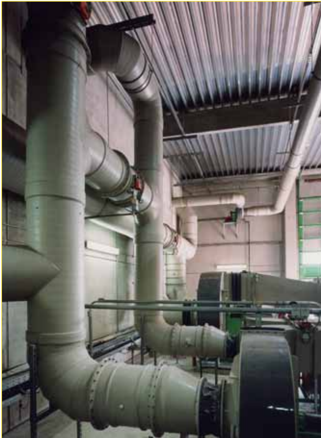
Bild 9: Belüftungsleitungen aus PE in einem Kompostwerk
