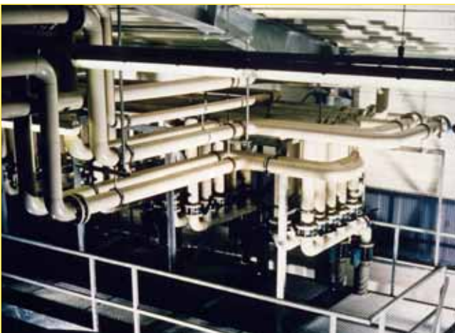
Bild 8: Verrohrung einer Industrieanlage aus PP
