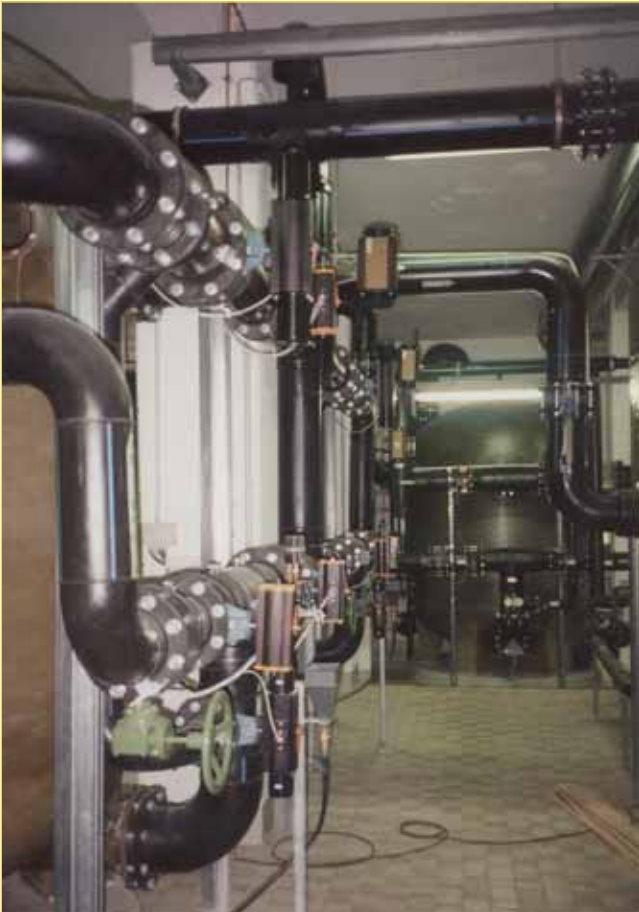
Bild 7: Badewasseraufbereitung komplett mit Armaturen sowie Mess- und Regeltechnik aus PE und PP
