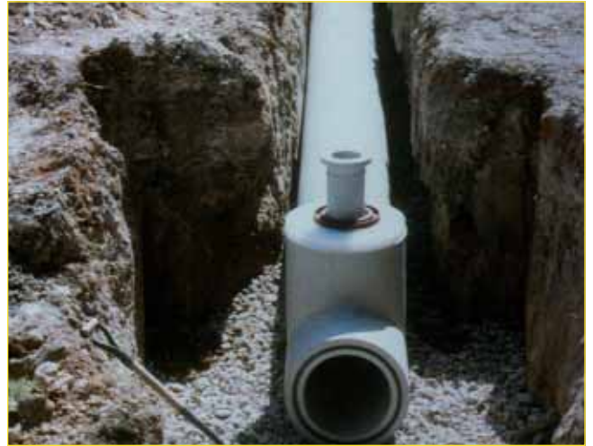
Bild 10: Doppelrohr mit Leckageüberwachung in einem Chemiebetrieb
