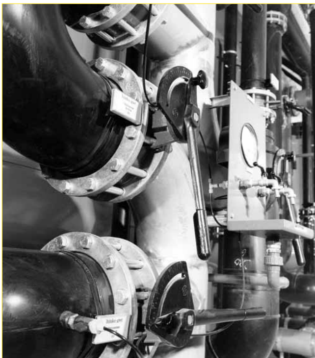
Bild 4: Einsatz von PE-Rohren in einer Wasseraufbereitungsanlage
