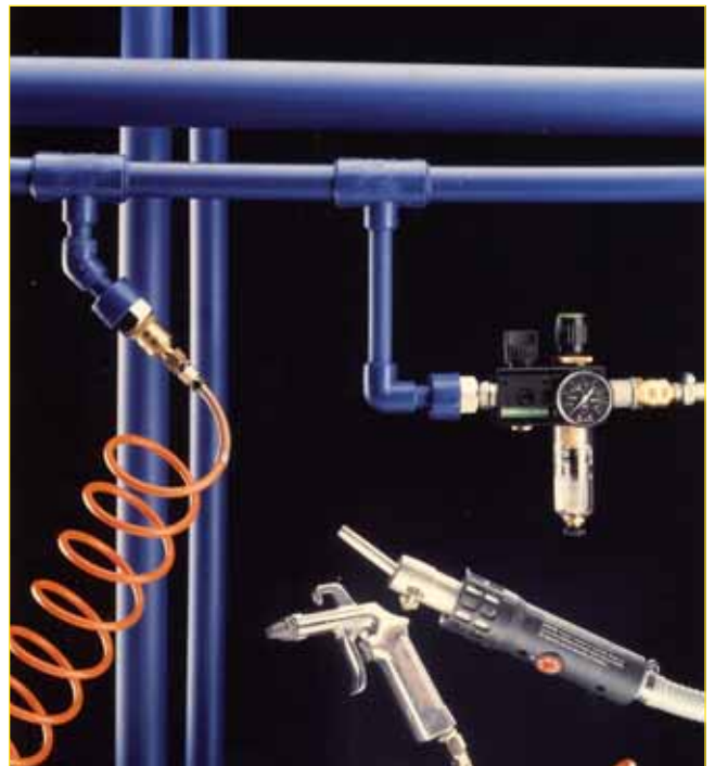
Bild 11: Druckluftleitung aus PE 100
