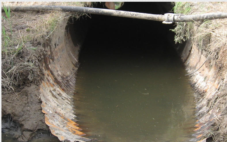
Abb. 1: Stahldüker mit Korrosionsschäden.
