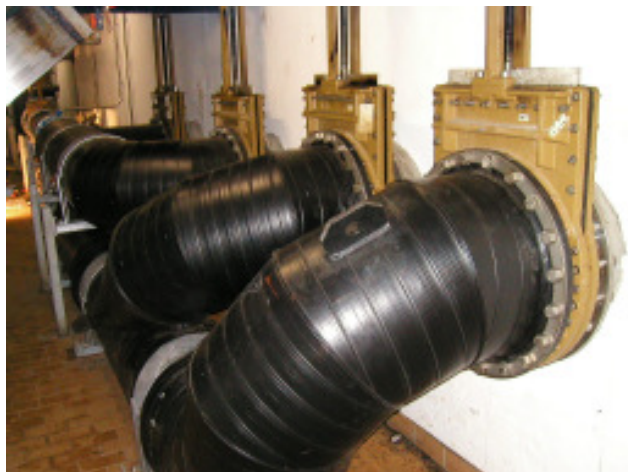
Zulauf DN 600 in die Denitrifikations-Straßen
