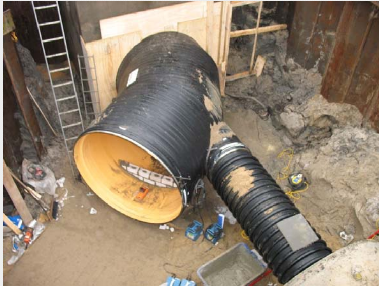
Abb. 4: Seitenzulauf DN 800 zur Vorflutsicherung
