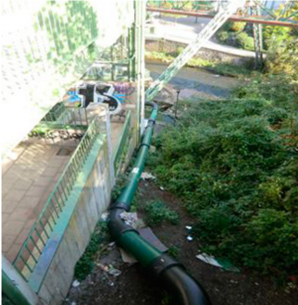
Abb. 4: Verlauf der oberirdischen Rohrleitung von der Bemberg-Treppe in Richtung Haltestelle.
