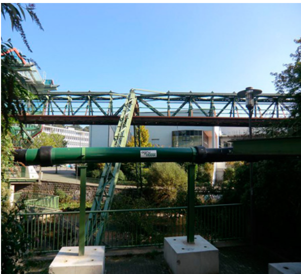
Abb. 5 Leitungsverlauf mit Aufständering.
