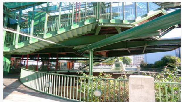
Abb. 2: Schwebebahnhaltestelle Kluse mit dem Verlauf der aufgehängten Rohrleitung in Richtung „Bembertreppe“. Rohre in gewünschter Sonderfarbe passend zur Haltestellen-Stahlkonstruktion.
