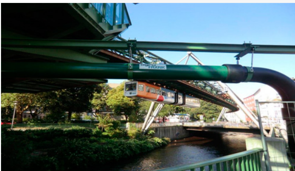
Abb. 1: Rohrverlauf unterhalb der Haltestelle Kluse. Konstruktion der Rohraufhängung zum freien Verschieben der Rohrleitung mit der Schwebebahn im Hintergrund.
