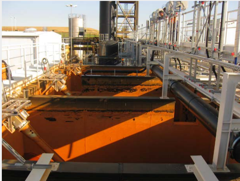
Abb. 5: Neutrabecken mit Korrosionsschutzauskleidung AGRU Sure Grip Betonschutzplatte PE
