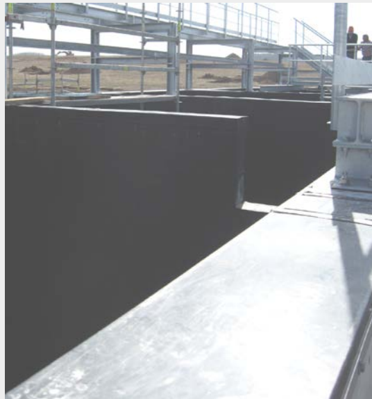
Abb. 4: Neutrabecken mit Korrosionsschutzauskleidung AGRU Sure Grip Betonschutzplatte PE
