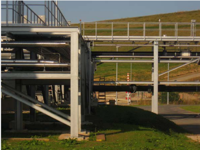
Abb. 3: Rohrbrücke mit PE 100 Rohren
