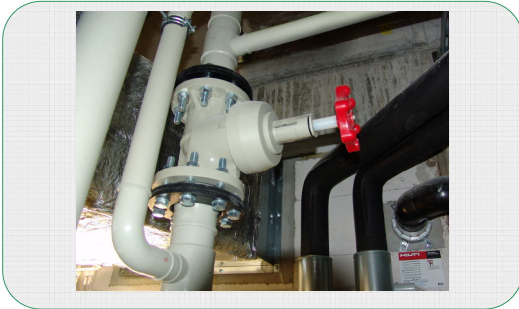
Abb. 2 Ventile in der Anlage verbaut
