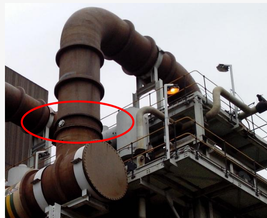
Bestands-Klappe aus GFK am Gaseintritt
