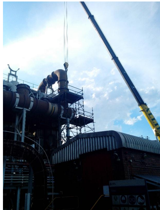
Einbau am Gaseintritt
