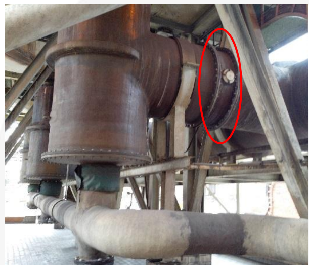
Bestands-Klappe aus GFK am Gasaustritt
