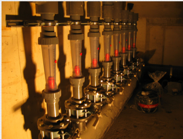
Abb. 3 Verteilerbalken aus PE inkl. Durchflussmessung im Keller des Technikraums
