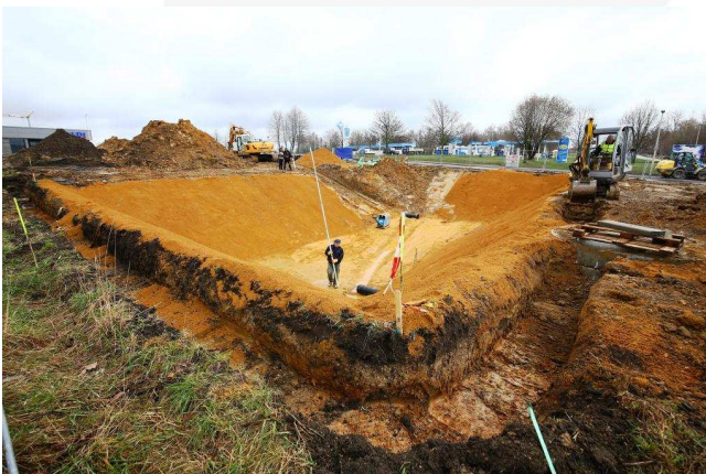
Das Regenrückhaltebecken mit mineralischer Ausgleichsschicht vor Installation des Abdichtungssystems aus Schutzvlies, Kunststoffdichtungsbahn und stabiler Schutzlage FRANK BVR 9000 HP
