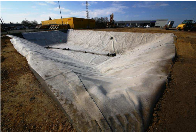
Baustellenansicht: Die FRANK BVR 9000 HP ist komplett im Becken verlegt. Jetzt nur noch mit Wasser aktivieren.
