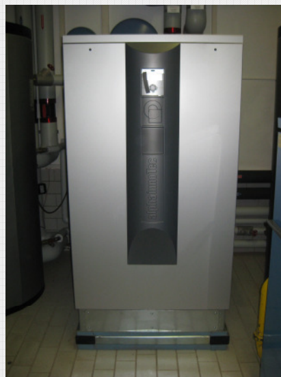
Abb. 3: Wärmepumpe (SWP 270 H, Hersteller: Alpha-InnoTec) im Heizraum
