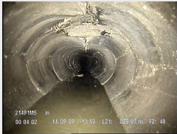
Bild 1: Einbrüche im Rohrscheitel des Betonkanals
