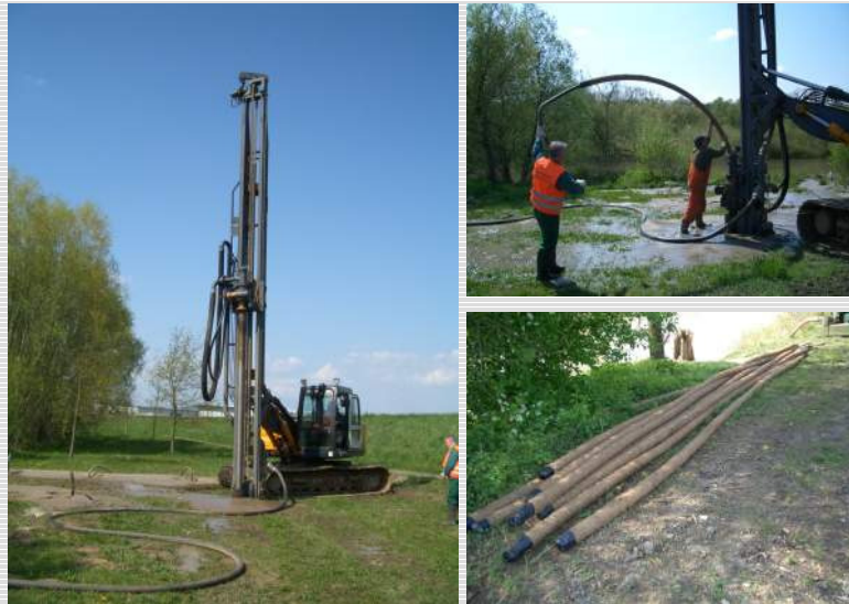
Abb. 5: Absenkung des Grundwasserspiegels
